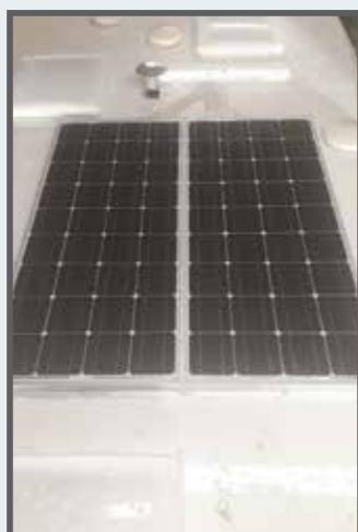
panneaux photovoltaïques sur le toit
